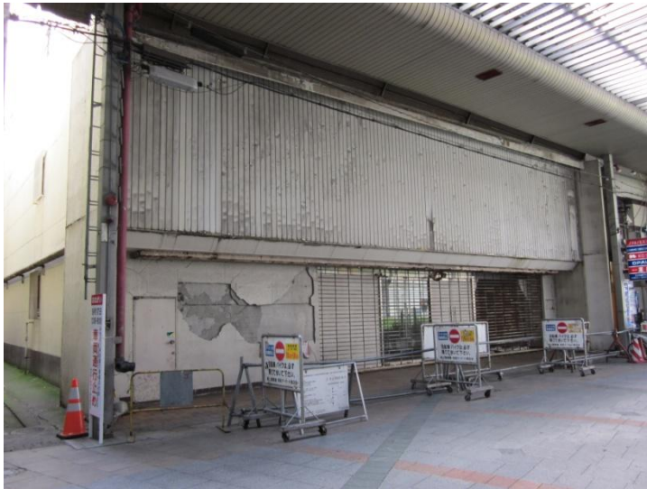
↑ トポス郡山店別館跡地 入口付近。 震災により一部壁やドアガラスが崩れ、入口付近は内部が見える状態に。 別館部分自体が大規模半壊を受け、2013年に解体された (2011年9月10日)
